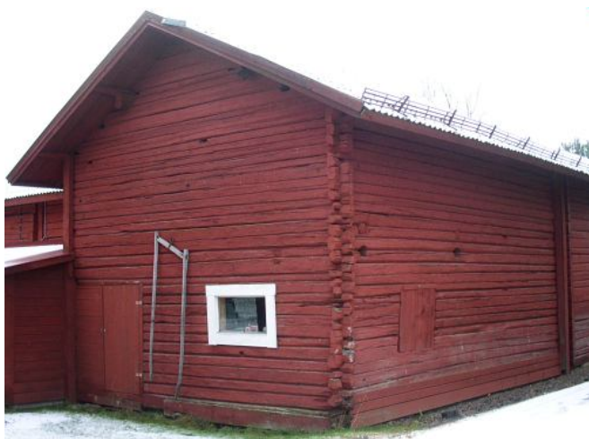
Länsmansgårdens trösklada ursprungligen byggd ca 1751. Bilden tagen från nordväst. Proven togs i den bortre, inbyggda gaveln mot söder.
